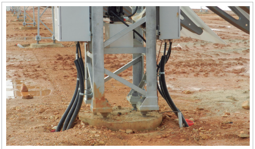
Tubería de Poliamida en Planta de Energía Solar - Moquegua
