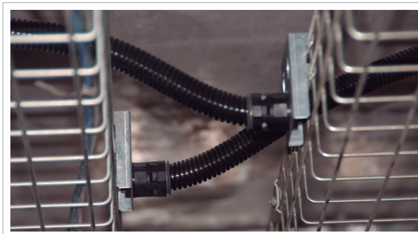
Tubería de Poliamida y Bandejas tipo Rejilla "Viafil" - Miraflores
