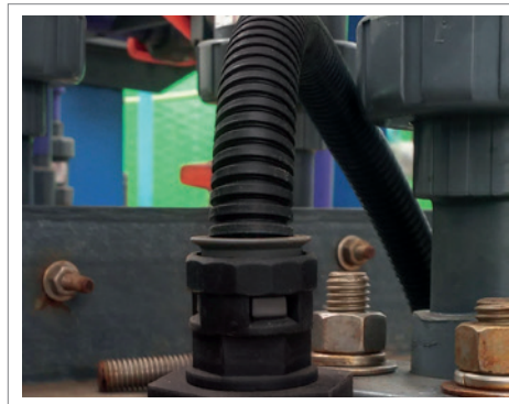
Tubería de Poliamida - Ica
