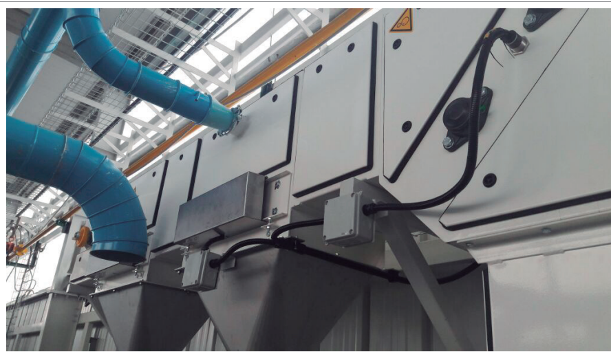
Tubería de Poliamida en Industria Alimentaria - Huachipa
