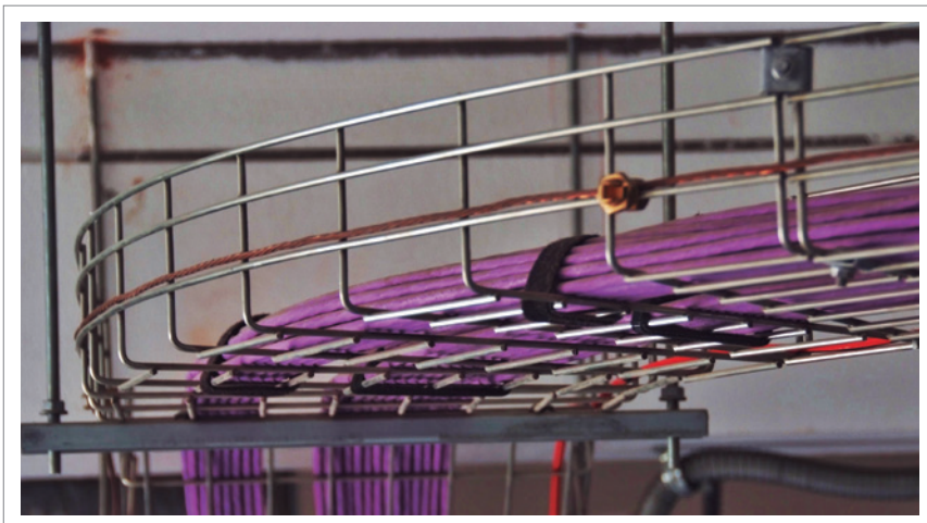
Bandejas tipo Rejilla "Viafil" con Acabado HR en Hospital - Ate
