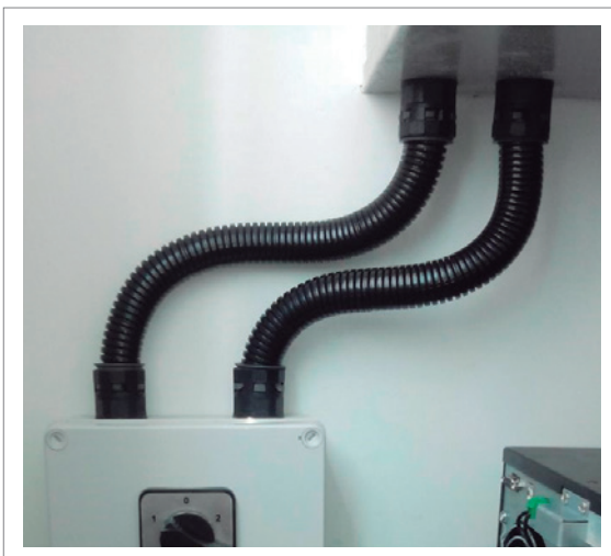
Tubería de Poliamida en Clínica - San Isidro
