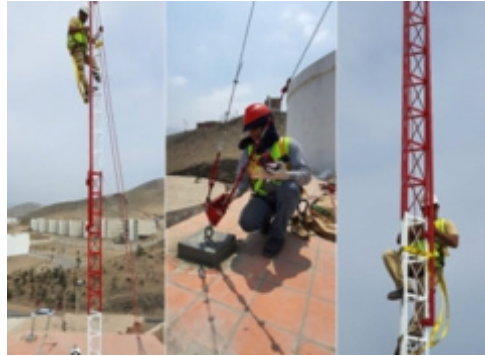
Torres Ventadas para Pararrayos
